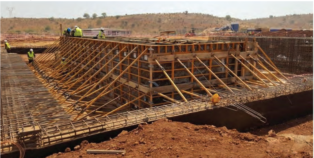
Centrale de Kayes, Mali
